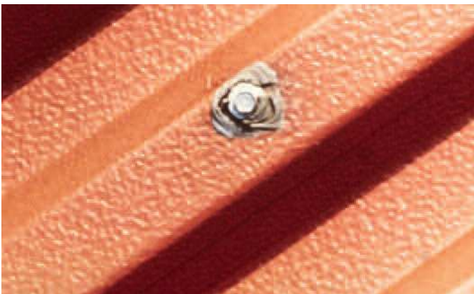
Beschädigte Halterung auf einer Dachbekleidung
