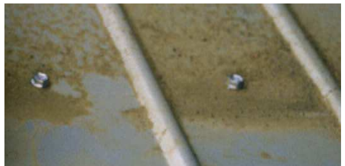
Schimmelbildung auf bandbeschichteter Stahlbekleidung
