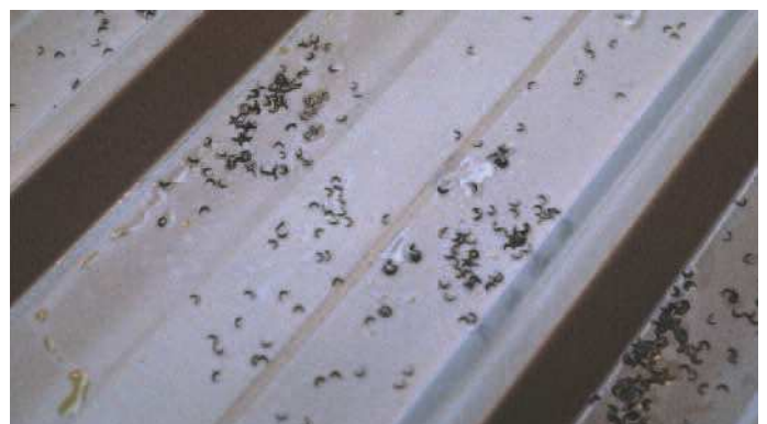
Reste von Spänen auf dem Dach
